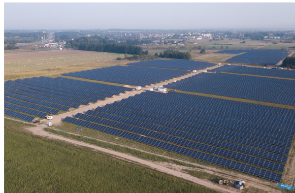
Sulechów (Panele fotowoltaiczne ustawione szeregowo na ziemi)
