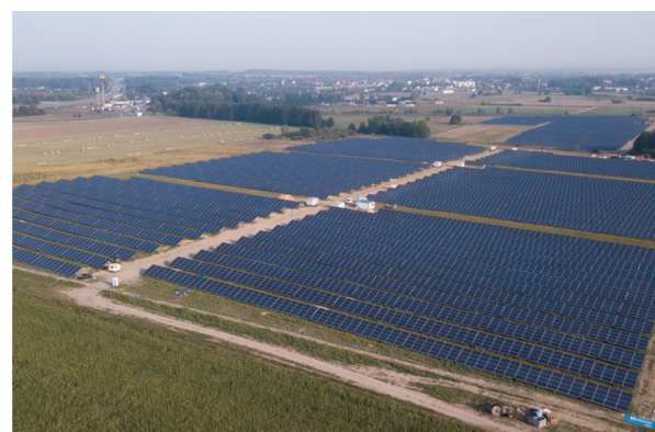
Sulechów (Panele fotowoltaiczne ustawione szeregowo na ziemi.)
