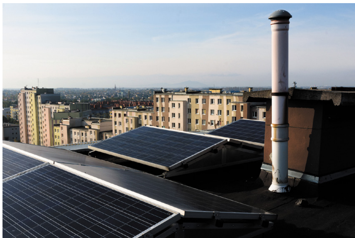
Wrocław (Instalacja fotowoltaiczna na dachach bloków) / fot. Bartosz Mrówka
